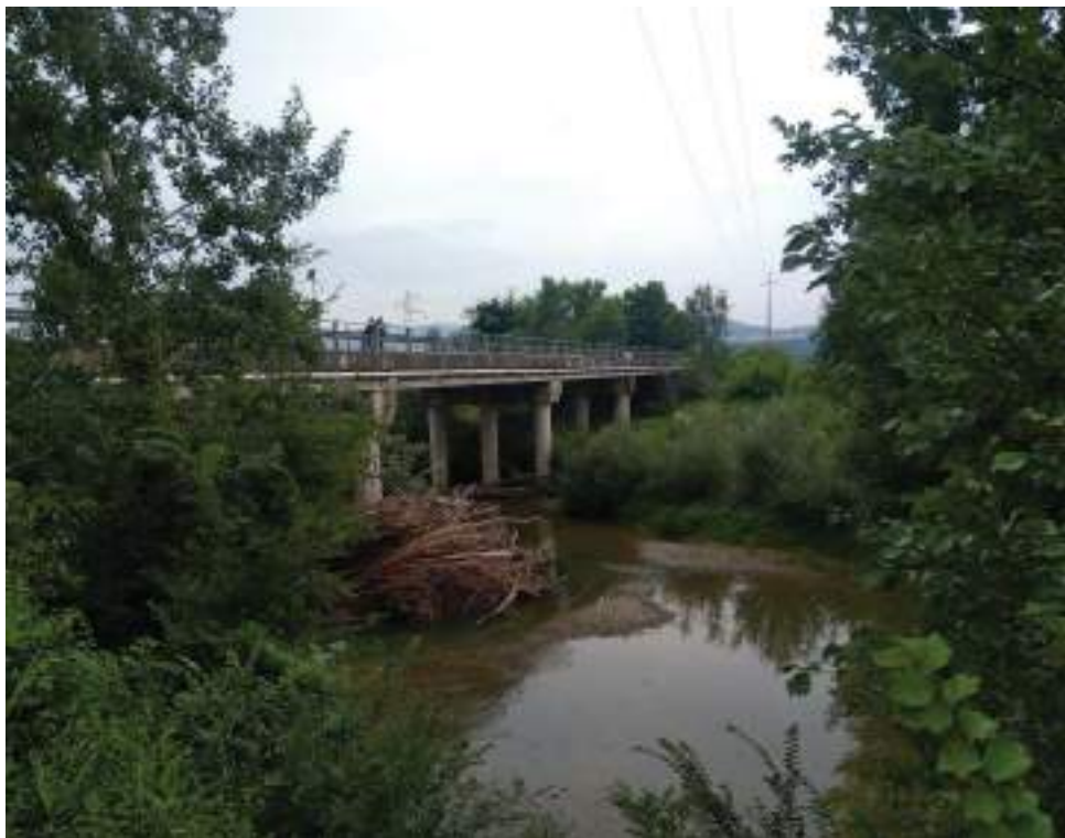
Fig. 6: Ponte sul Fiume Cecina – Loc. Casino di Terra. Si nota un enorme accumulo di materiale legnoso estremamente pericoloso in caso di piena
